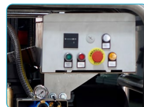
Panel de control con contador de horas de funcionamiento y parada de emergencia.
